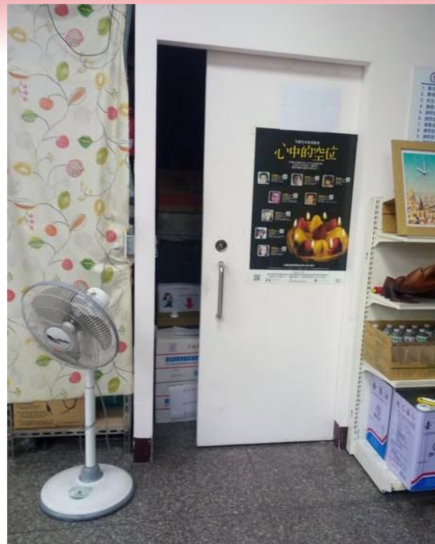
無障礙廁所堆滿雜物
